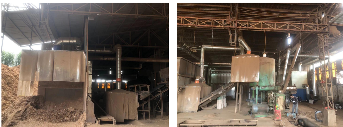
图4.1-1 废气处理措施
