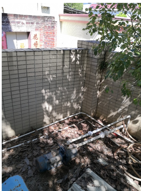
图3-4 生活污水水泵抽取用于场地绿化
