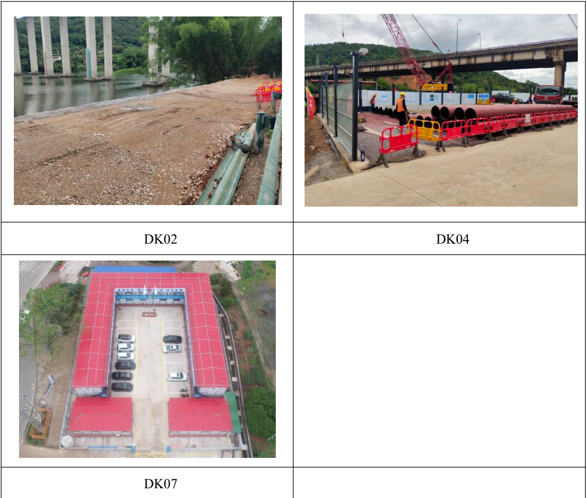
图 4-2 全部已损毁土地现场情况
