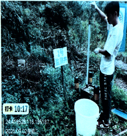
地下水 1 号监测井
