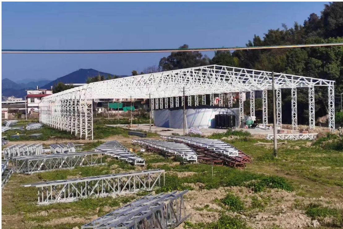
图 4-1 项目区现状 (DY06 农业灌溉及农产品冻库-损毁部分)
