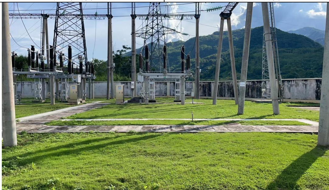
站址绿化照片
