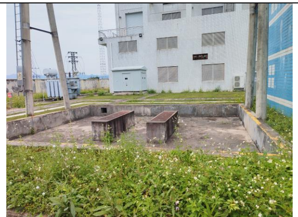
站内 2#主变预留位置
