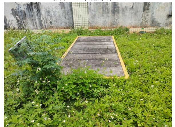
站内事故油池
