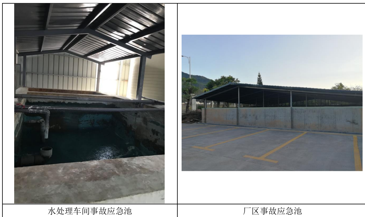
图2.2-2 事故应急池现场照片
