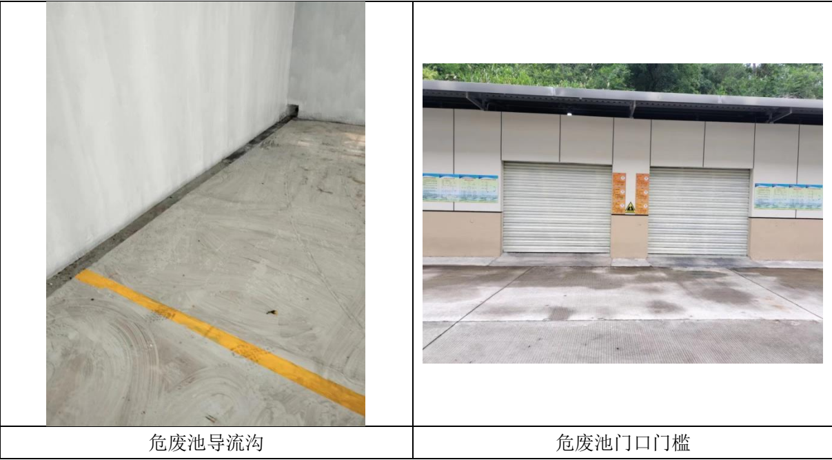
图2.2-1 导流沟现场照片
